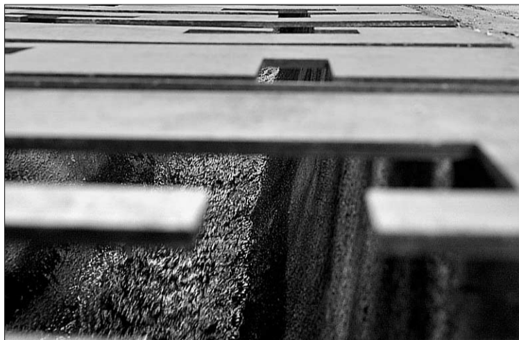
La cacera de regantes ha sido protegida con una rejilla. / KAMARERO
