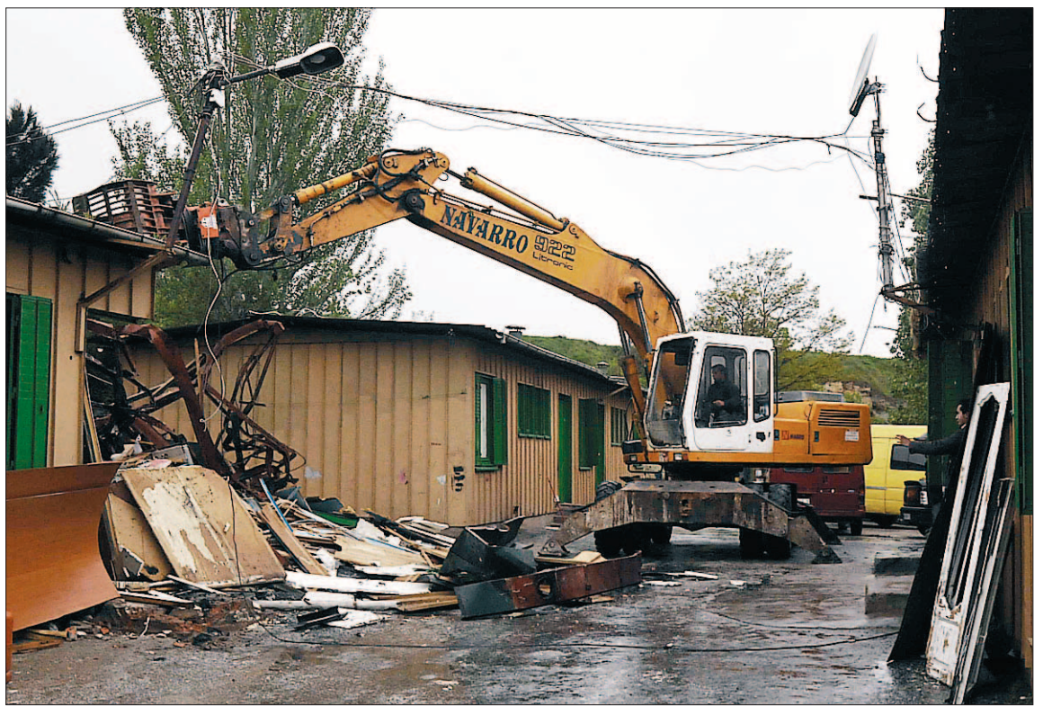
Imagen de archivo del derribo de infraviviendas en el núcleo de la carretera de Madrona. / JUAN MARTÍN
