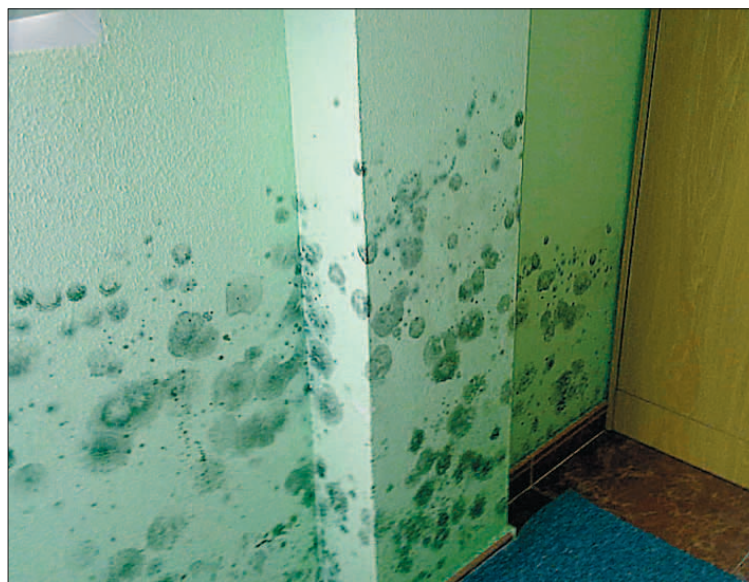
Pared de una vivienda afectada por graves problemas de humedad. / EL ADELANTADO
