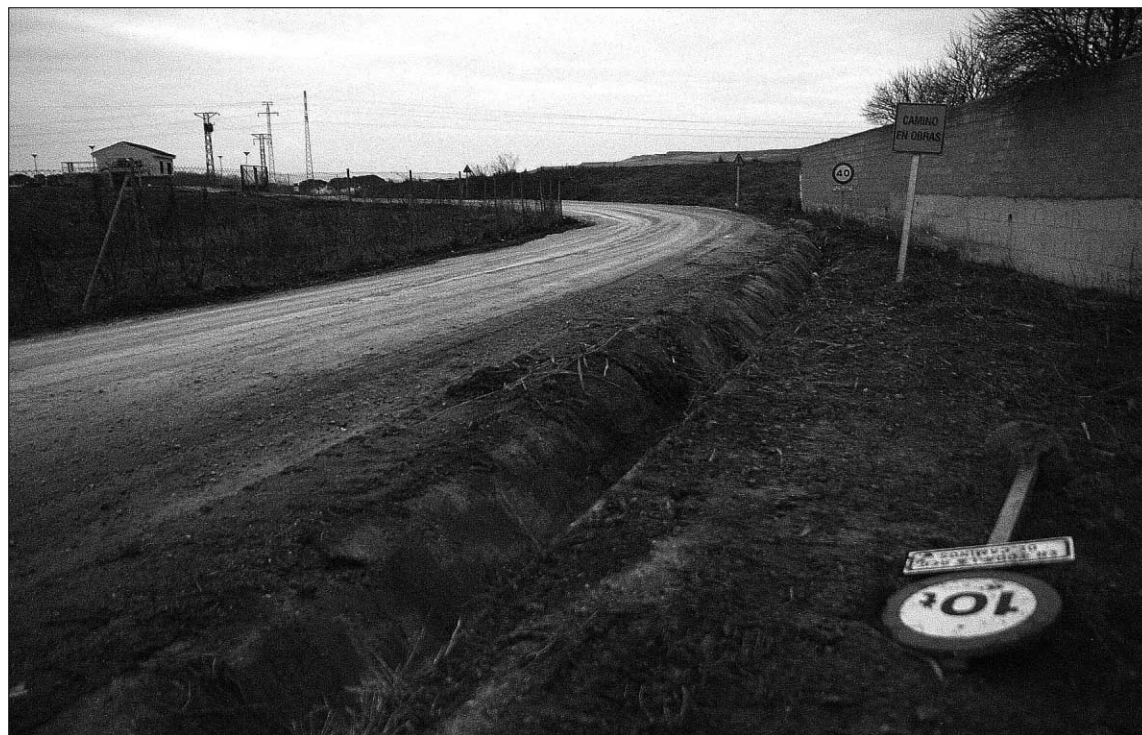
Estado actual del camino del Salinero, tras las primeras actuaciones acometidas por Tragsa. /GABRIEL GÓMEZ
