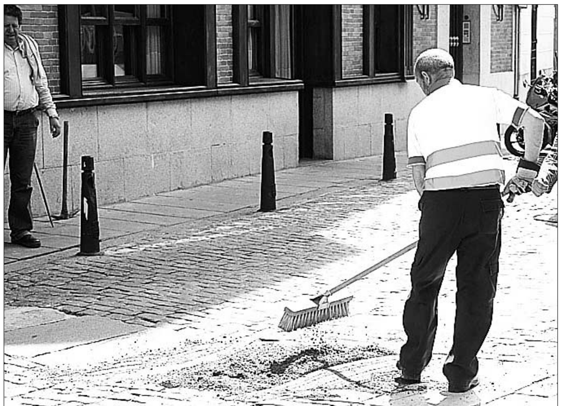
Las losetas han sido reparadas en varias ocasiones sin éxito. / KAMARERO
