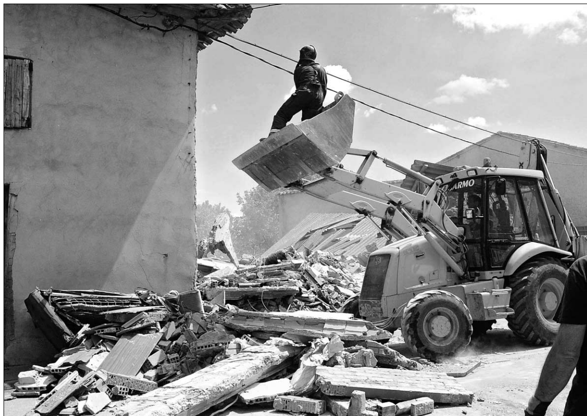
Estado en el que quedó la vivienda tras la explosión de gas. / PEIO GARCÍA (ICAL)
