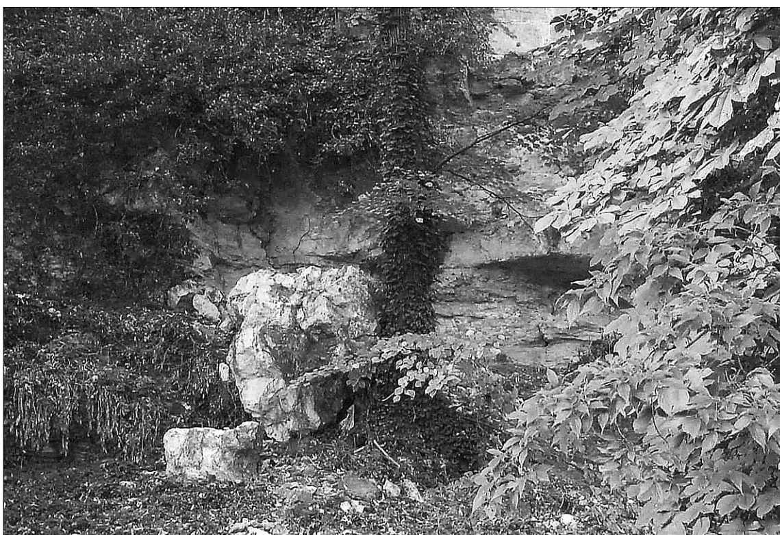
Imagen de las piedras que se desprendieron, procedentes de la base de un cubo de la muralla de la zona norte. / J. MARTÍN
