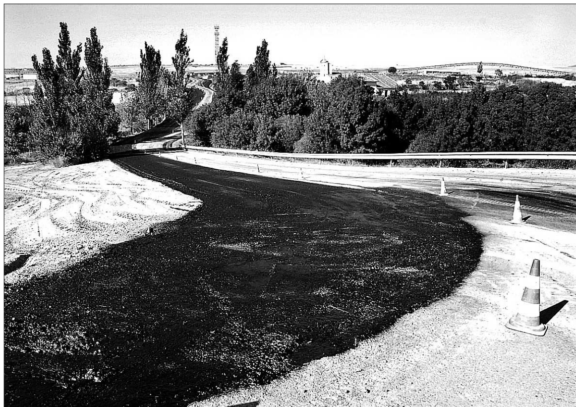
Imagen de las obras del vial que dará acceso provisionalmente a la estación del AVE en Segovia. / BEATRIZ VELASCO
