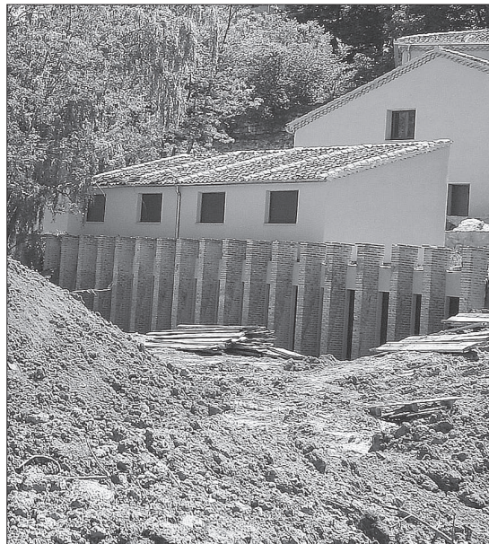
Amigos del Patrimonio pide el derribo de los muros junto al Eresma. / F.P.
