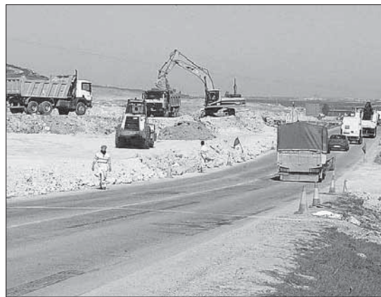
Estado de las obras hasta el cruce con la CL-603. / F. PENALOSA
