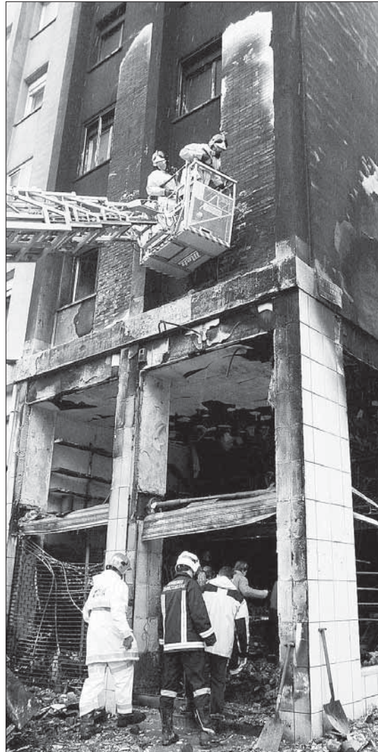
Bomberos inspeccionan la ferretería incendiada. / JESÚS DIGES (EFE)
