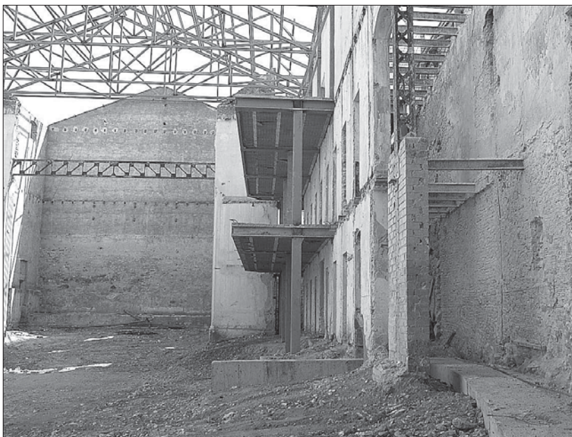
Aspecto del interior del Teatro Cervantes, después de la paralización de las obras por parte de la Junta. / JUAN MARTÍN
