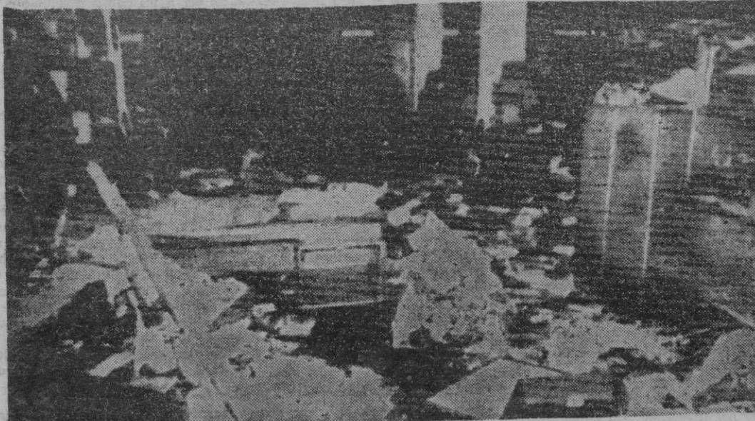
Ocho atentados sufrieron ayer diversas dependencias de la compañía eléctrica Iberduero, en el norte de España. En las fotos de Efe, edificio donde están instaladas las oficinas en Las Arenas (Vizcaya) y el estado de uno de los despachos
