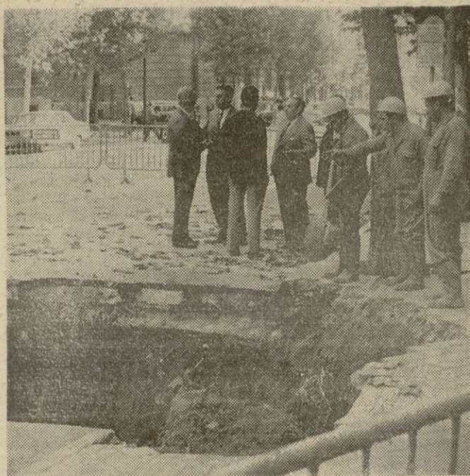
MADRID. — Vista del enorme socavón que se ha producido en la calle Martínez Campos. Ya se procede a su tapado por los servicios municipales correspondientes. — (Foto Cifra Gráfica).
