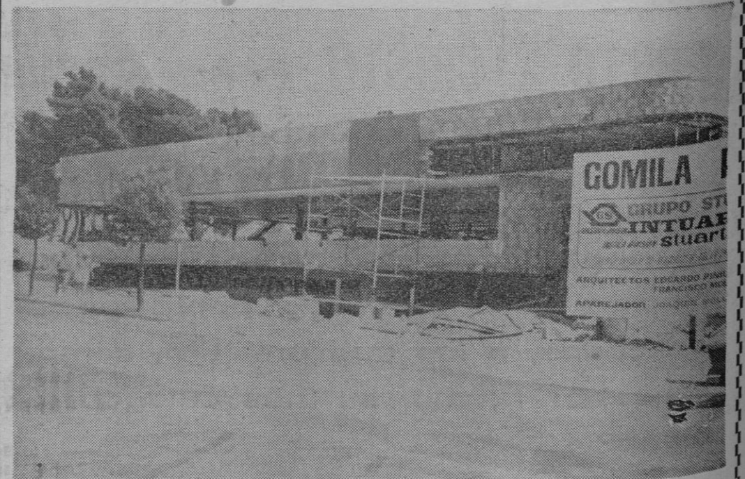
HACE UNOS AÑOS, en este mismo lugar, se centraba la actividad ténistica, en Palma, porque tenía sus pistas y su local social el Tenis Palma. Ahora, en este tramo de la calle Calvo Sotelo (frente a la calle Bosque) se está construyendo un formidable complejo deportivo, donde se dispondrá de piscina descubierta y otra de invierno, pistas de tenis, gimnasio, bolexas, parque infantil, mini-golf y otros múltiples detalles. Ya no veremos más aquel solar que muchos debieron imaginar sería destinado a levantar algún hotel o torre de apartamentos. Se trata de una obra que podrán disfrutar todos los mallorquines y residentes en nuestra ciudad. (Foto de Ripoll)
