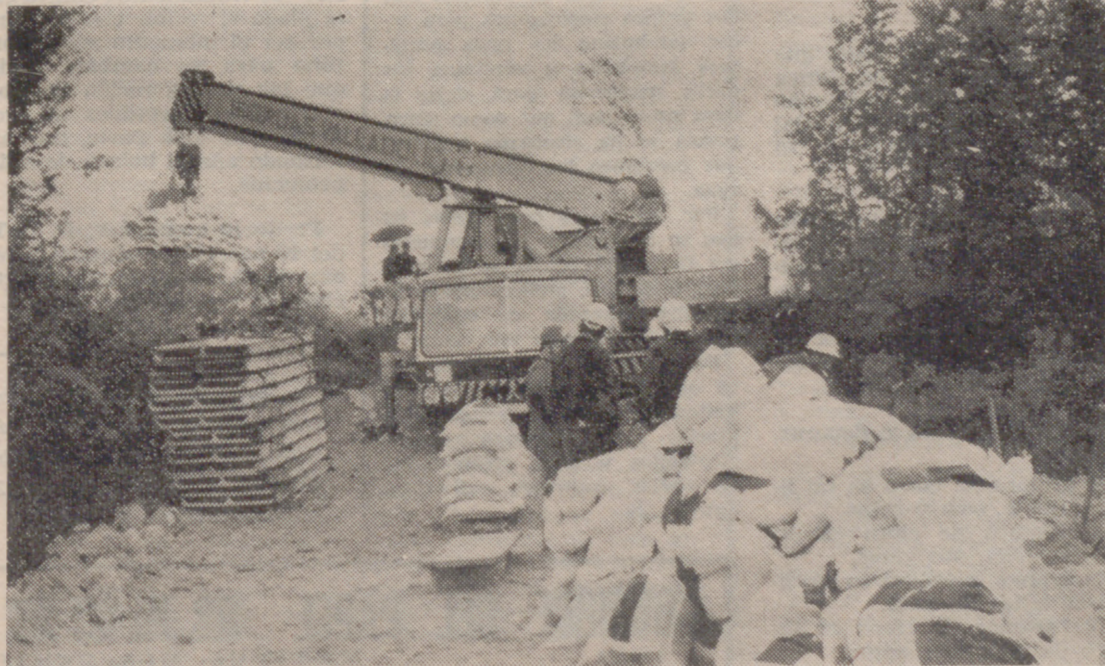
Esta potente grúa sirvió, durante todo el día, para transportar el material necesario a la otra orilla del canal, así como sacos terreros, paneles y vigas.
