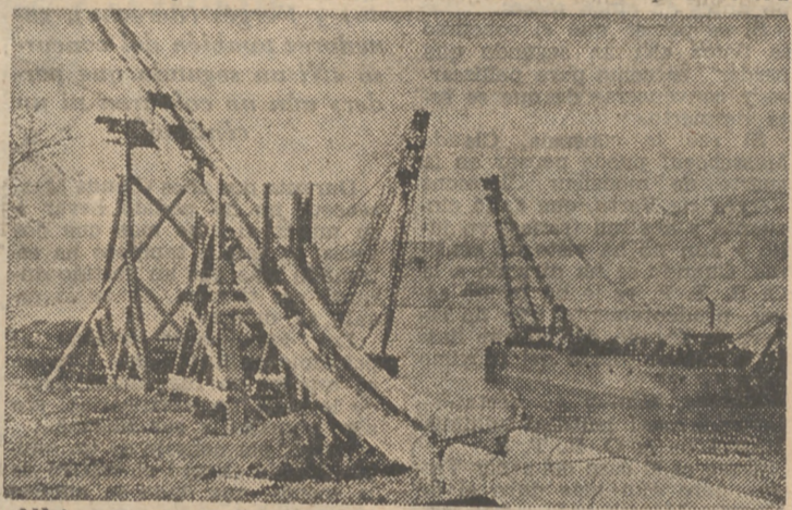
Ultimos tramos del oleoducto que une París con El Havre, en función de realizar un transporte más rápido del petróleo. Las grúas, río abajo, pasando el puente de Epinay, se encuentran dispuestas para levantar los dos tubos que reposaban sobre caballetes a orillas del Sena. Este oleoducto es hoy una realidad
