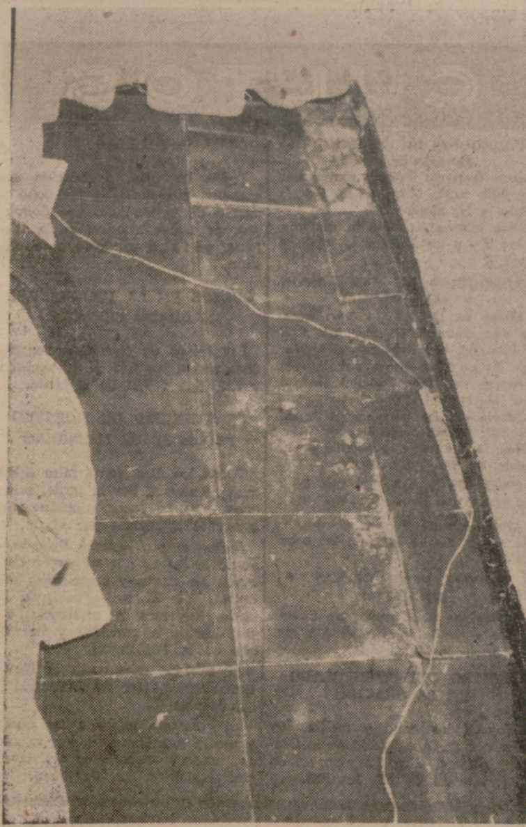
Hundimiento del piso en una habitación.
