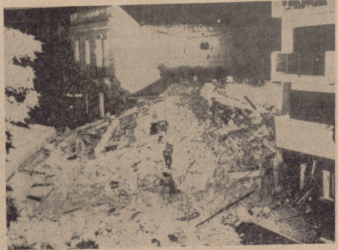
BUENOS AIRES.—Miembros de las brigadas de rescate trabajando en la búsqueda de posibles víctimas después del derrumbamiento de un edificio en construcción de catorce pisos. El derrumbamiento sobrevino cuando una piscina instalada en un piso alto, perdió toda su agua debido a una rotura.—(Telefoto Upi Cifra.)
