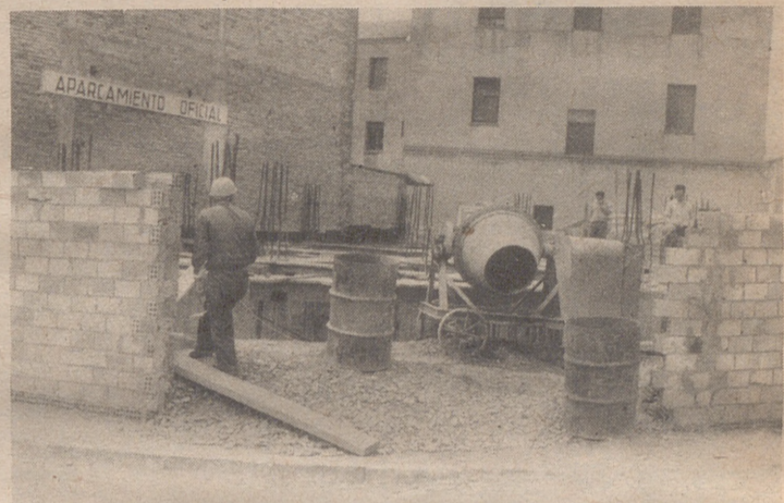
En el solar que se venía empleando como aparcamiento oficial, junto al Mercado Municipal y no muy lejos de la Casa Consistorial de Ejea de los Caballeros ha comenzado una de las obras más importantes
