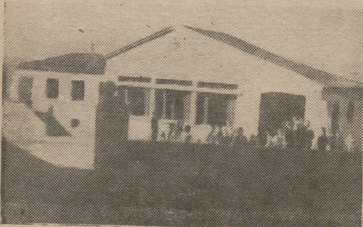
Una de las escuelas municipales en construcción, además de un grupo de diez grados
