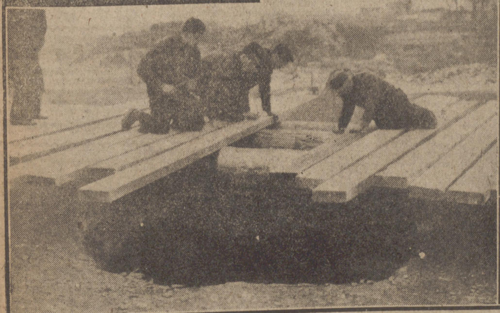
En Romainville se produjo un socavón que tuvieron que apuntalar los carpinteros de París. El hundimiento del piso lo produjo un camión, que quedó absorbido por el gran agujero, llevándose a la profundidad al vehículo, con su conductor. Los bomberos no pudieron actuar en los primeros momentos, debido a los desprendimientos de tierras que se sucedían, y tuvieron que esperar a que se colocaran las vigas de contención para rescatar al chófer.
