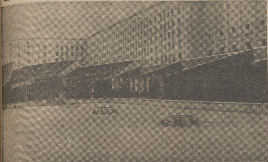
La estructura metálica montada en la Lonja de los Nuevos Ministerios, donde se está instalando la Exposición representativa de los XXV Años de Paz
