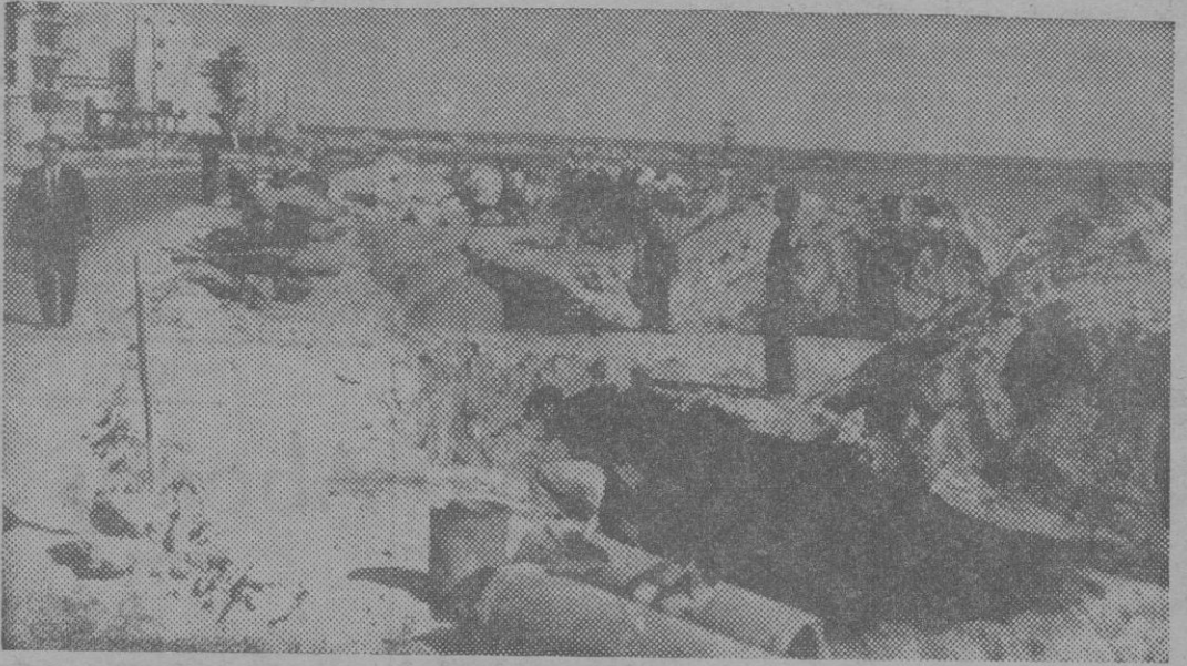
UNA OBRA IMPORTANTE, HA SIDO EL NUEVO SANEAMIENTO, QUE VIENE A SOLUCIONAR UN PROBLEMA DE CIERTA MAGNITUD ESTAS OBRAS NO PUEDEN CONSIDERARSE TOTALMENTE TERMINADAS. CONTINUARAN EN LA PLAYA DE PALMA
