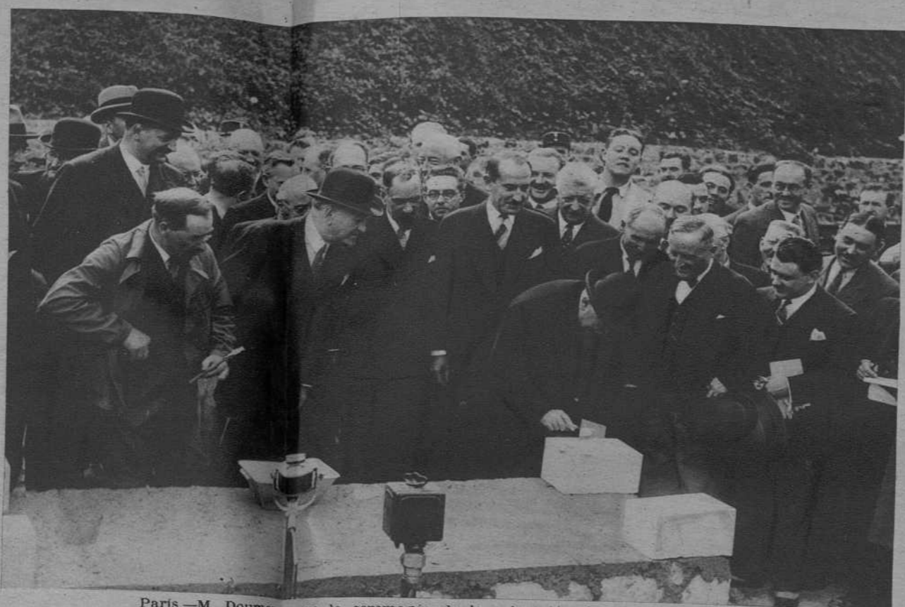
Paris.—M. Doumergue en la ceremonia de la colocación de la primera piedra de la futura estación del Oeste.—(Fot. Keystone)
