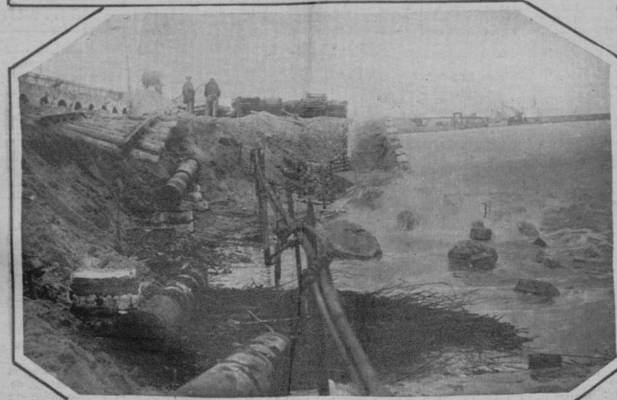
Las inundaciones de Bélgica.—El dique de Zeebrugge, destruido por las aguas.—(Fot. Consorcio)
