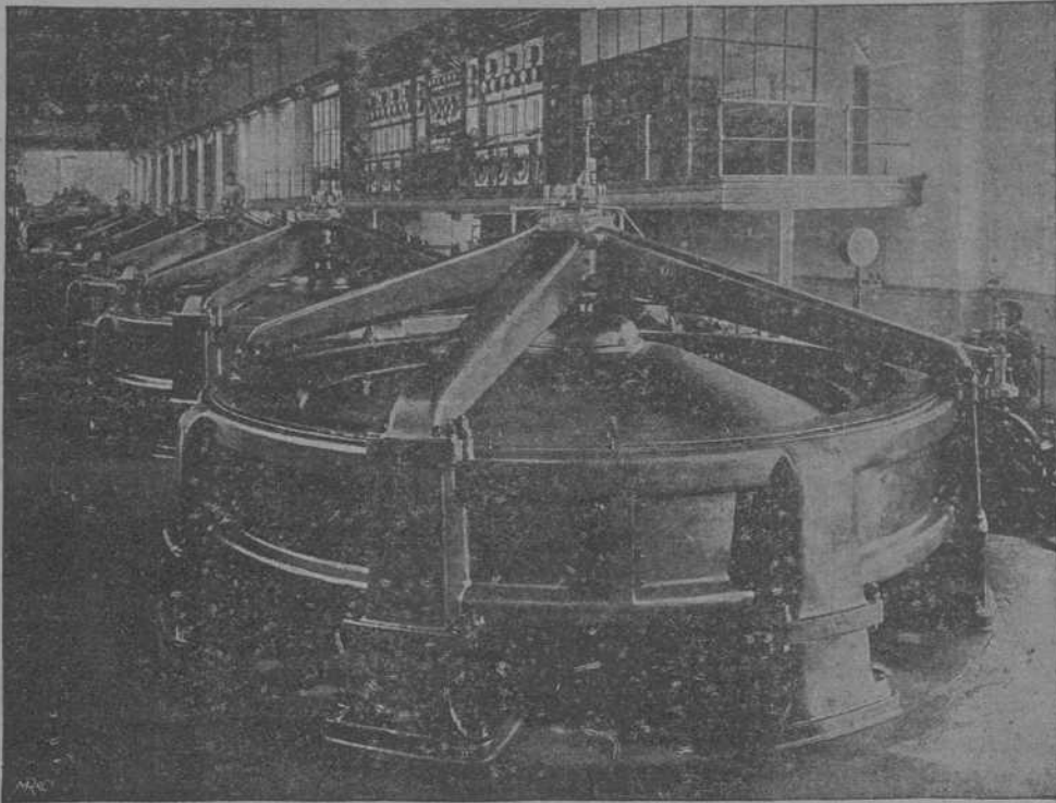
ESTACIÓN CENTRAL RHEINFELDEN Dinamos alterna trifásica movida por turbinas 600 kw. 6800 voltios
