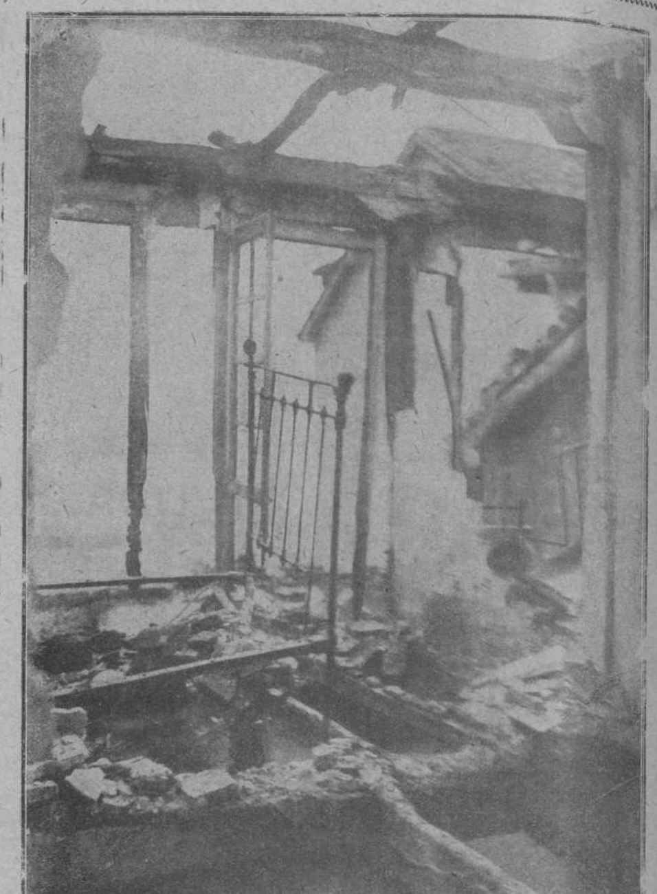
DEL INCENDIO DEL VIERNES.—Un aspecto del interior de la casa quemada en el Prado de San Roque. (Fot. Samot)
