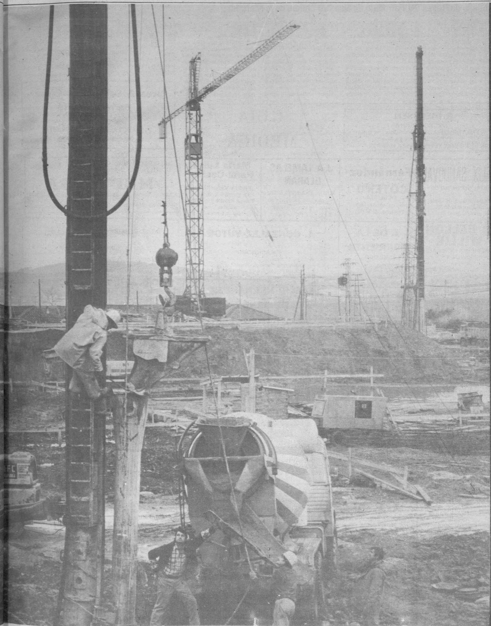
Aspecto parcial de la obra de Anthana, en fase de pilotaje. Constructora: COVINOSA
