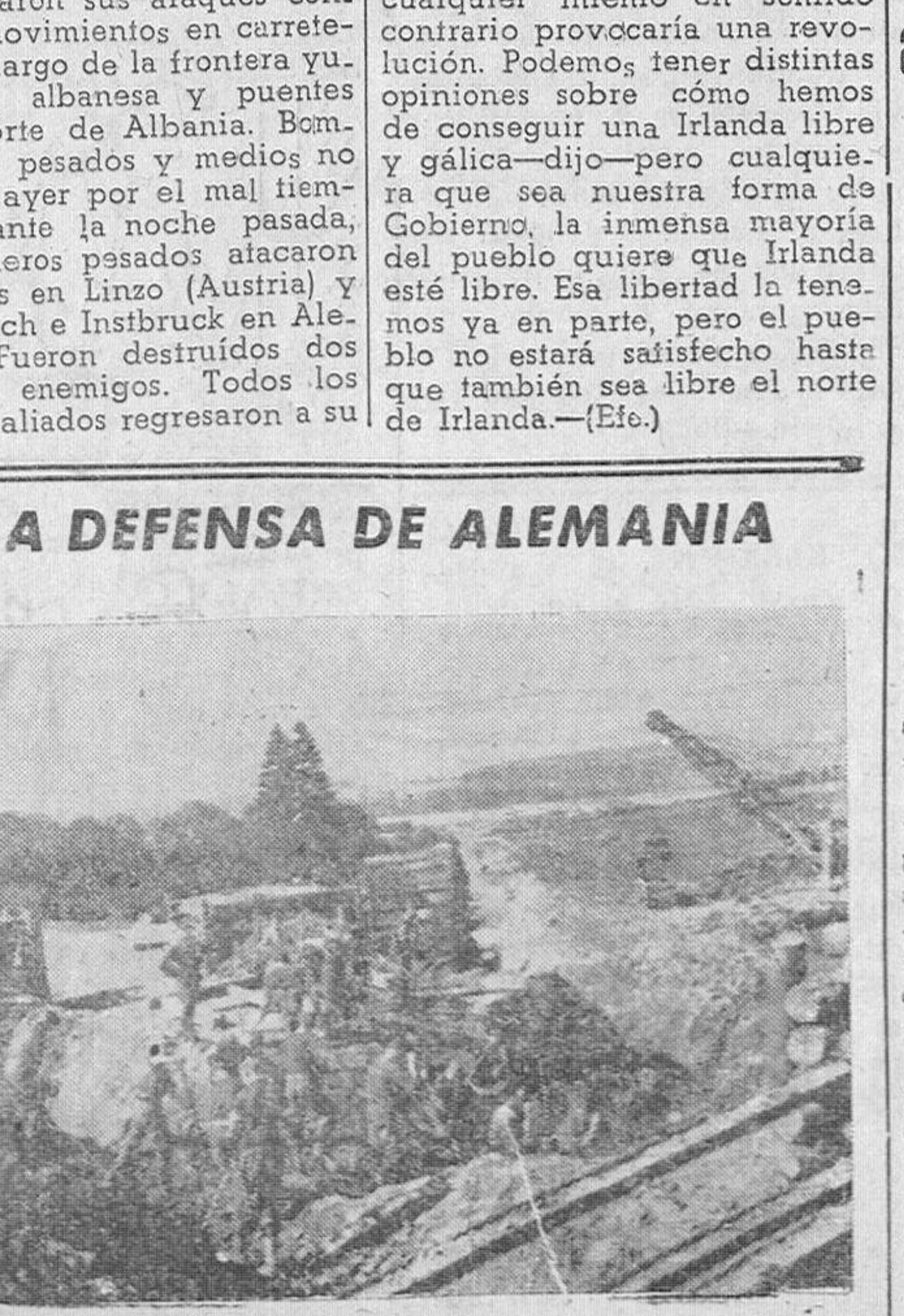
Hombres del Servicio de Trabajo Alemán, construyendo barreras antitanques en la frontera oeste de Alemania (Foto Weltbild).
