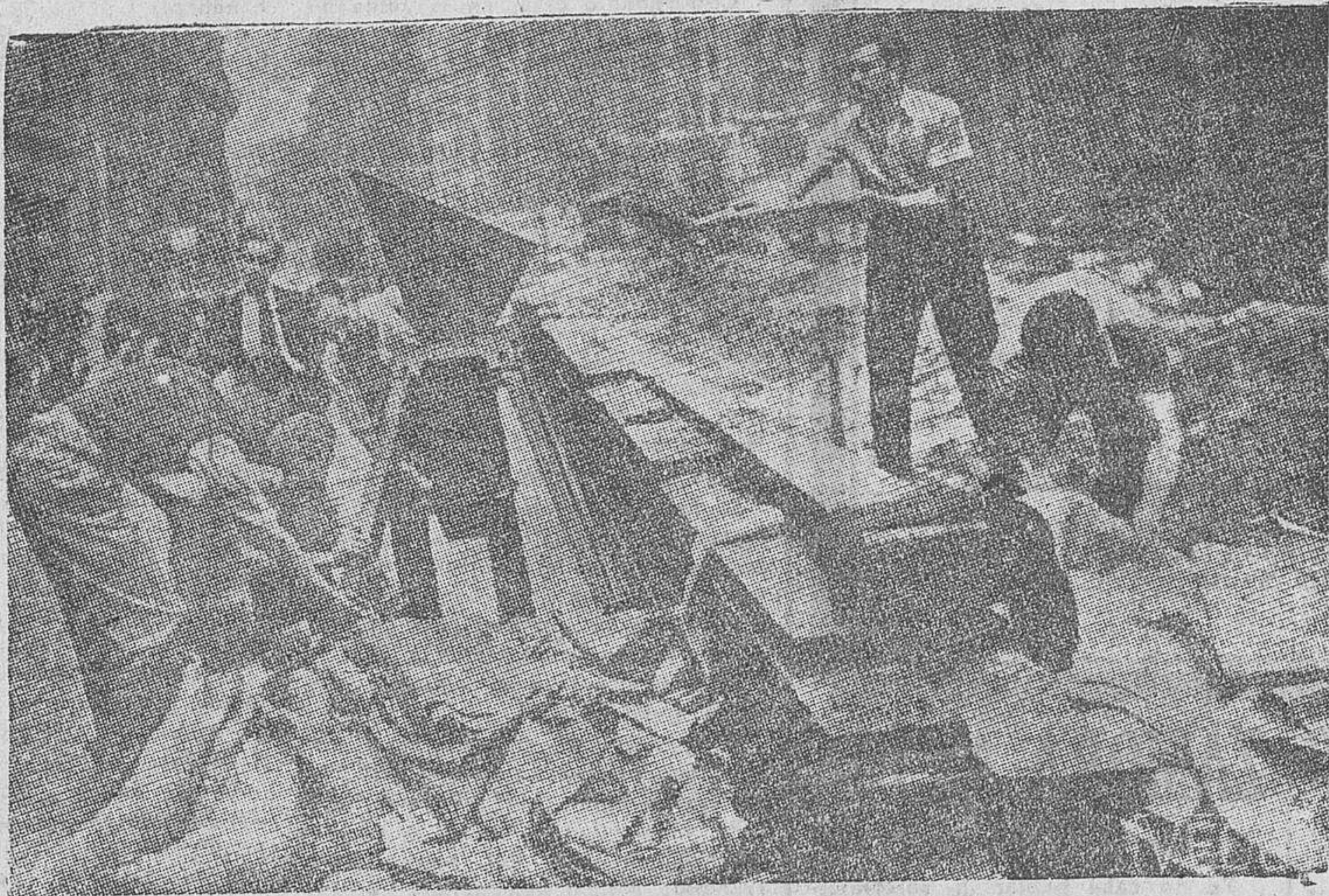
En la capital británica reina una extraordinaria actividad. Han sido movilizados brigadas de obreros y aun de voluntarios, que febrilmente se dedican a construir refugios para en el caso de incursiones aéreas. Uno de estos aspectos de la construcción de subterráneos, recoge la presente fotografía
