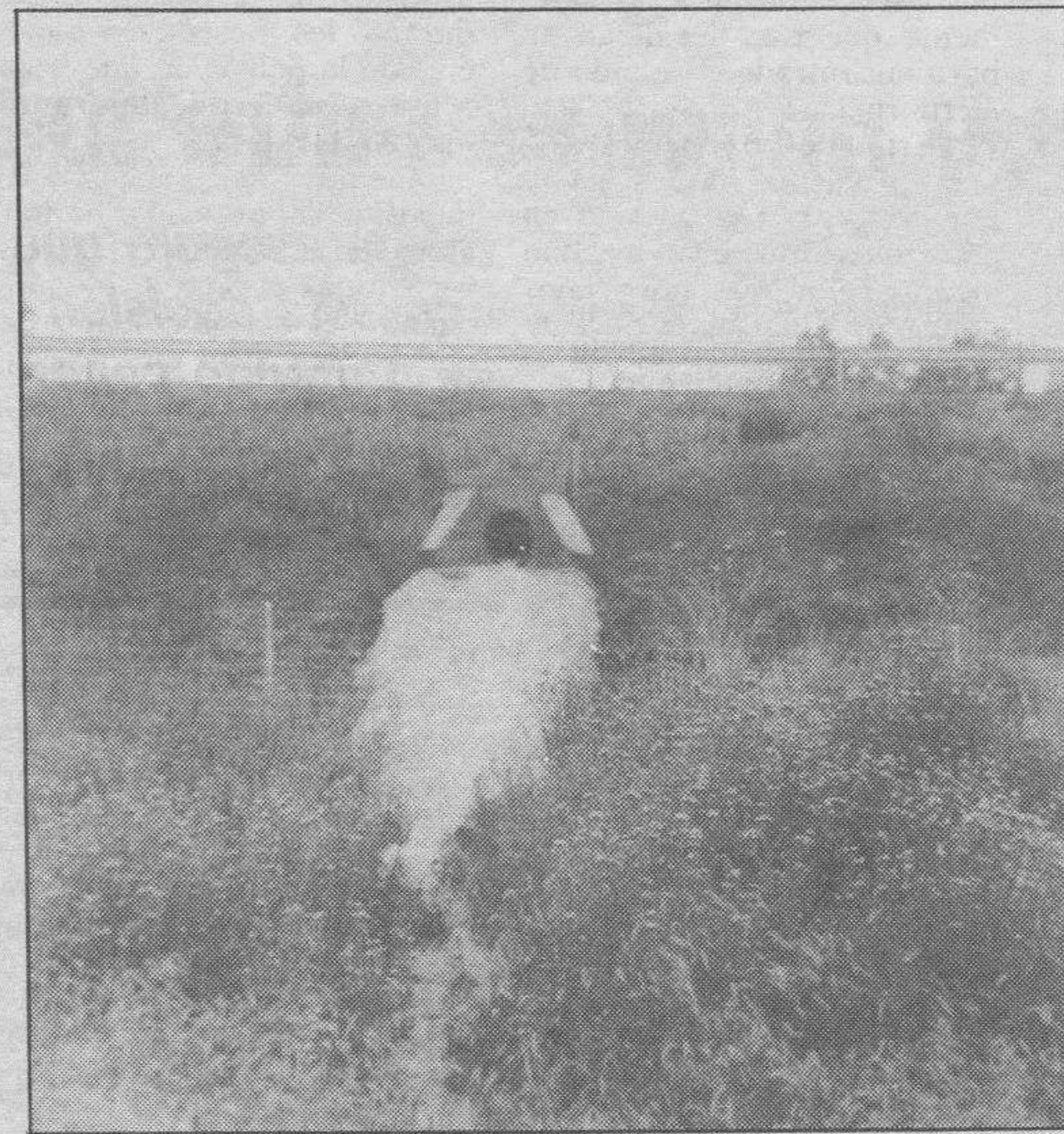
En la mediana de la Autovía de Castilla no hay canalización.
