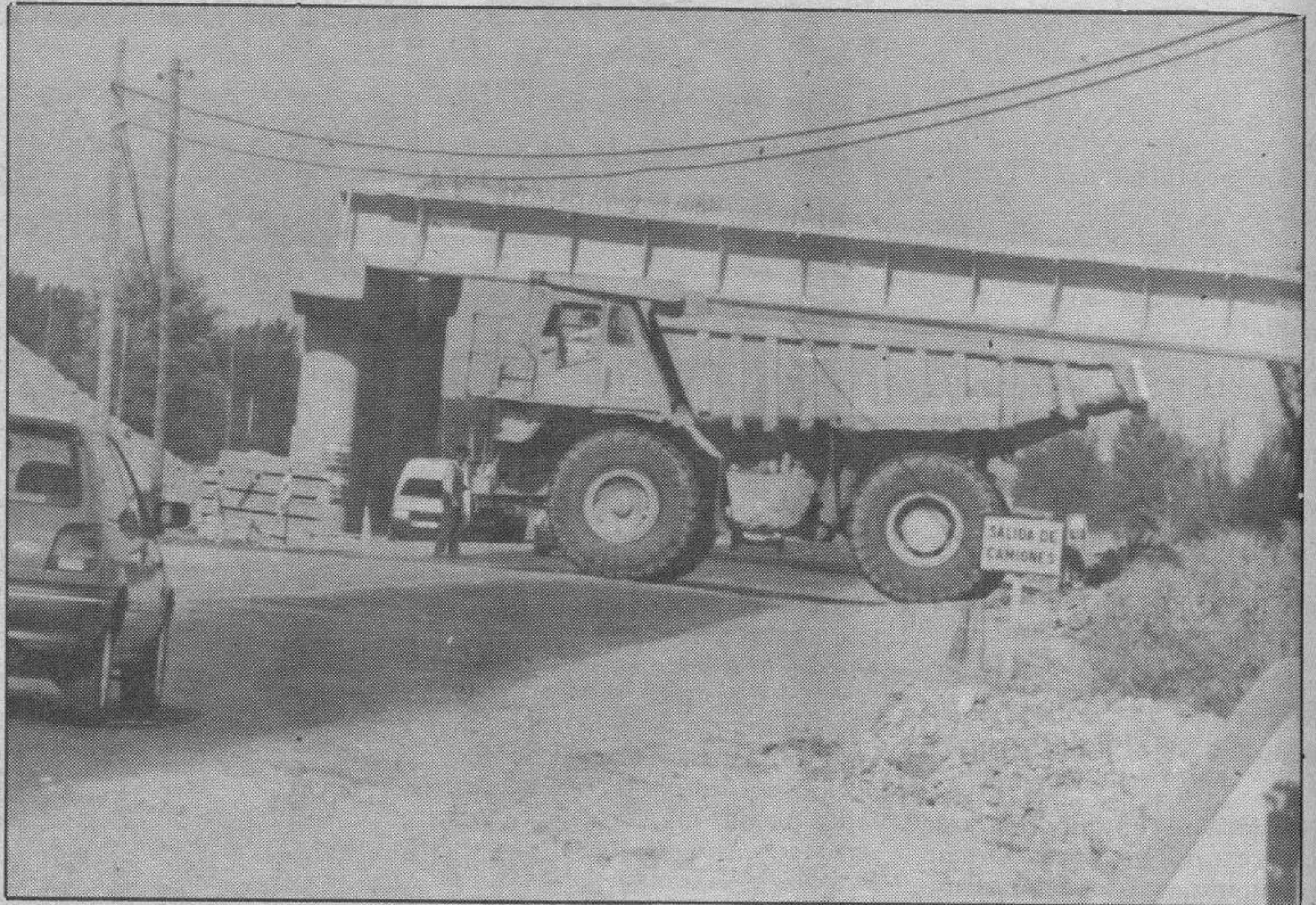
Las obras de la autovía continúan en el tramo arandino, con polémica incluida. (Foto: Lara)
