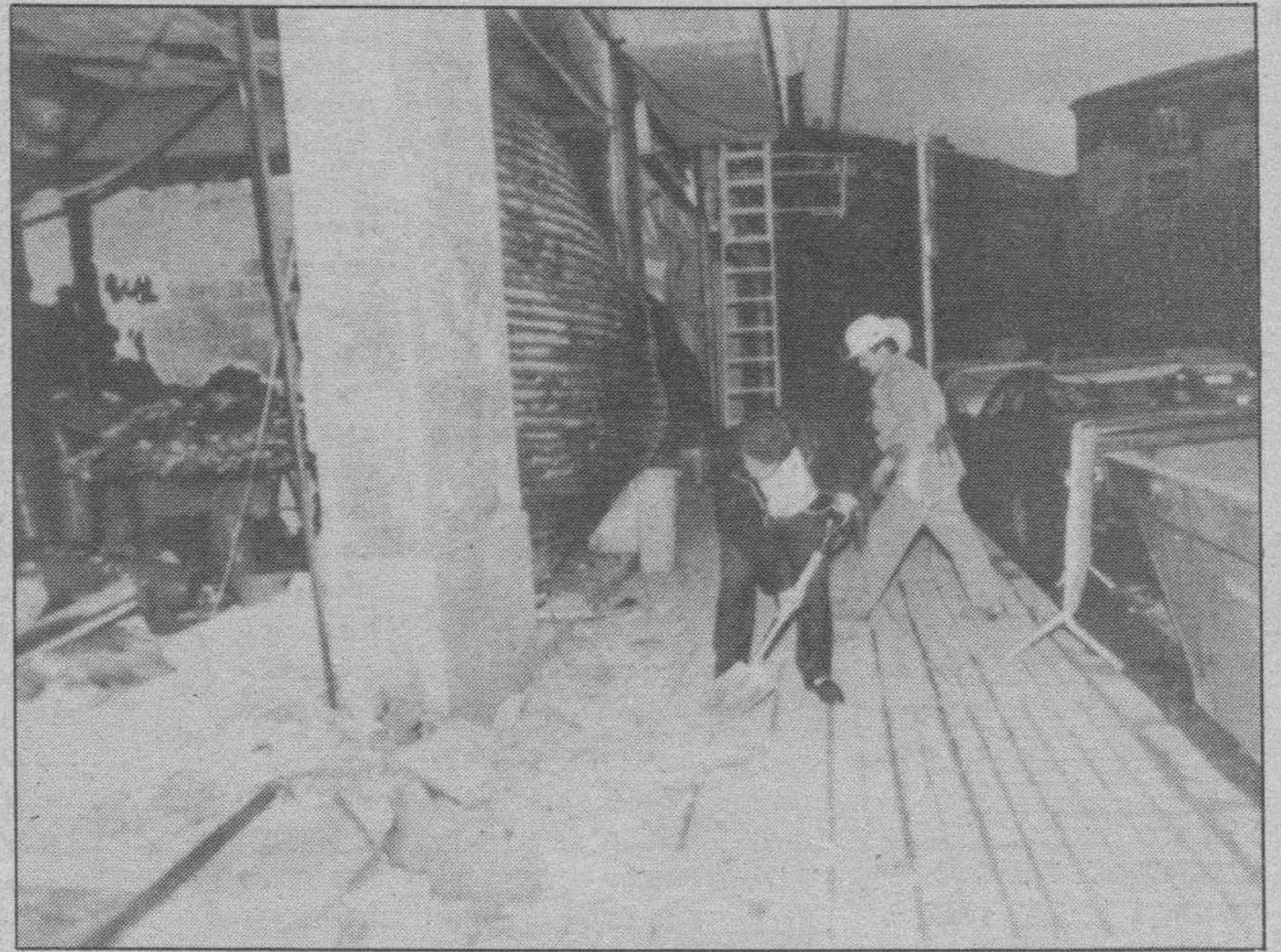
A primeras horas de la tarde de ayer comenzaron las tareas de desescombro en las viviendas afectadas por la explosión. Efe
