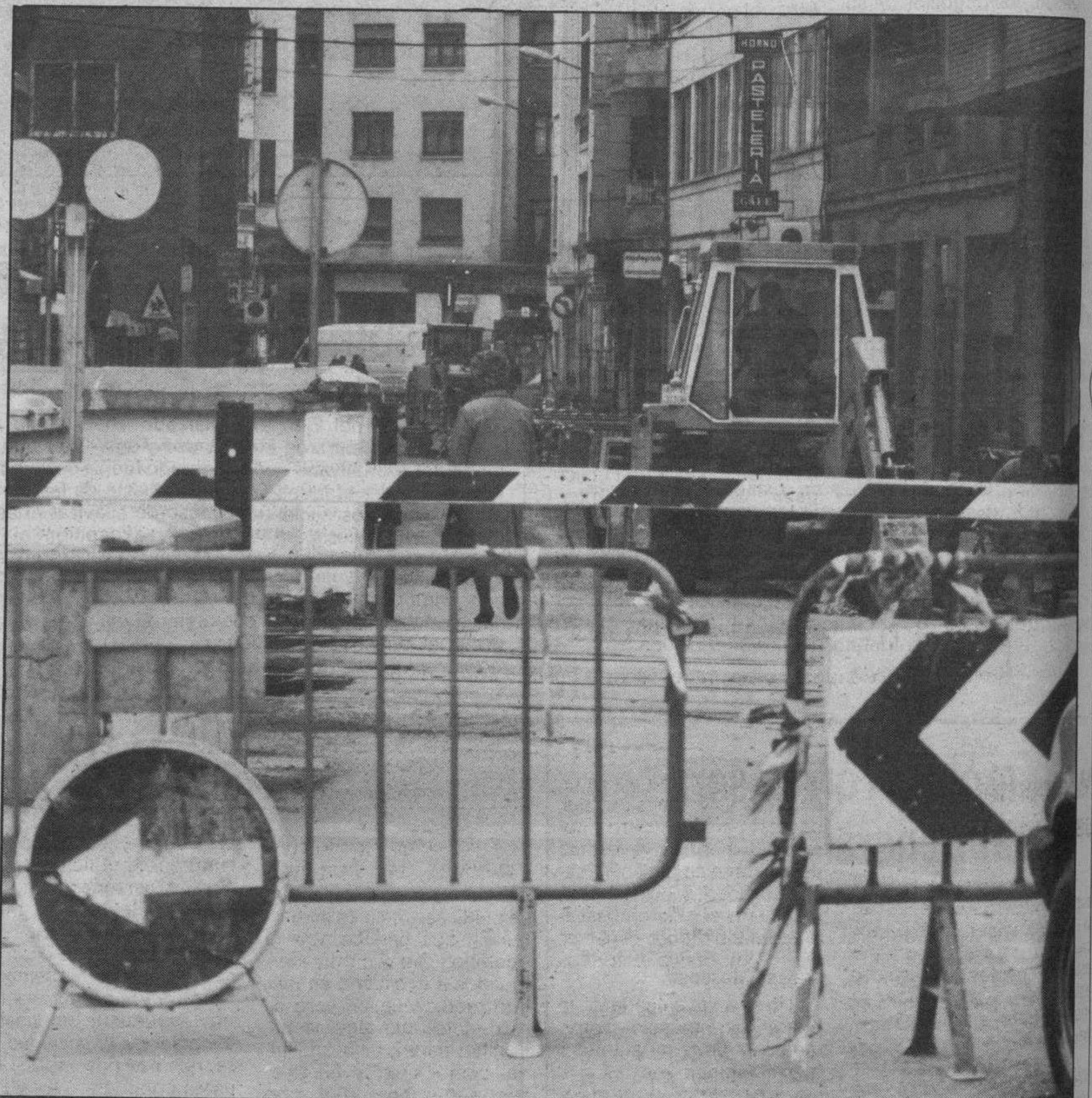
Cerrada por obras. — Además de las vías, las obras... La calle San Julián de nuestra ciudad presentaba ayer este aspecto. Para este tramo, perpendicular a San Pablo, sólo quedaba eso para aumentar el colapso circulatorio. Esperemos que las obras duren poco... menos que las del ferrocarril.
