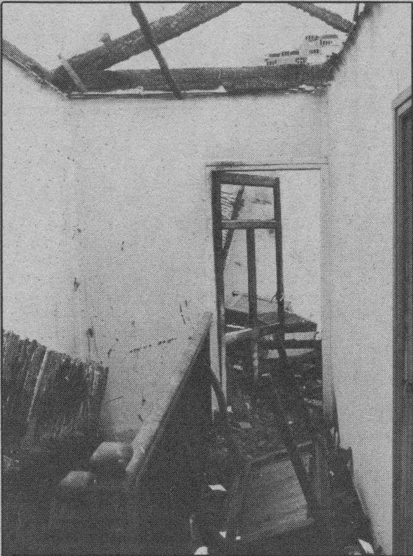
Vista de una de las habitaciones dañadas por el siniestro.
