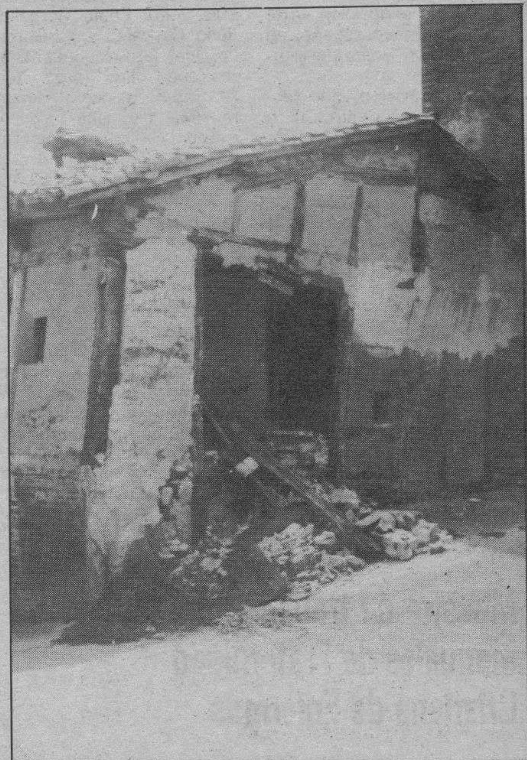
La casa de Santo Domingo de la Calzada se cae.
