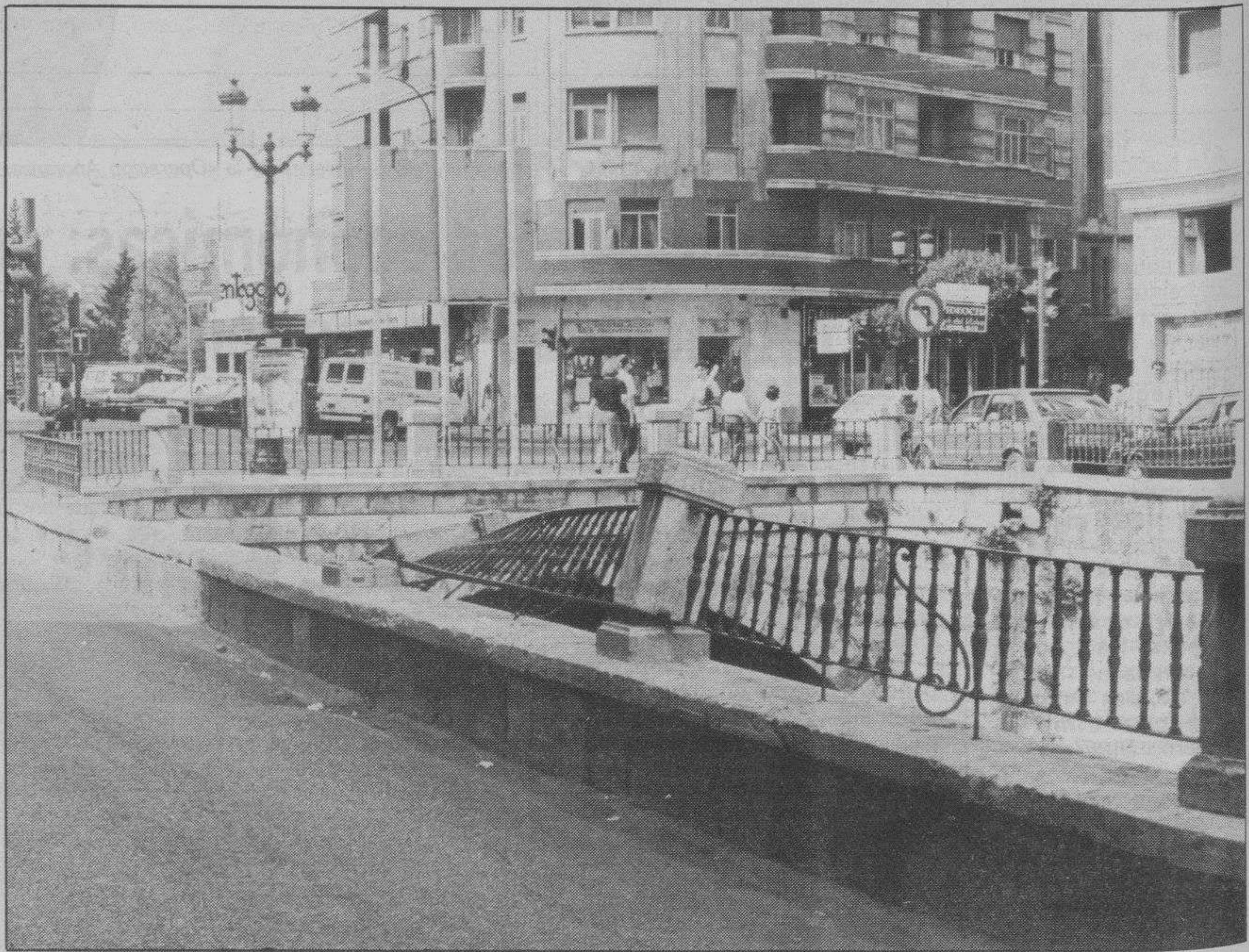
Barandilla derribada. — Se está procediendo a la reposición de la barandilla del río Vena en su último tramo en el que cruza la calle de Vitoria de forma subterránea. Un camión derribó los boliches de piedra y la barandilla de hierro, como ya informamos. Es una calle que tiene difícil acceso por los aparcamientos y resulta peligroso entrar con fuerza. Pronto este lugar presentará su aspecto habitual.
