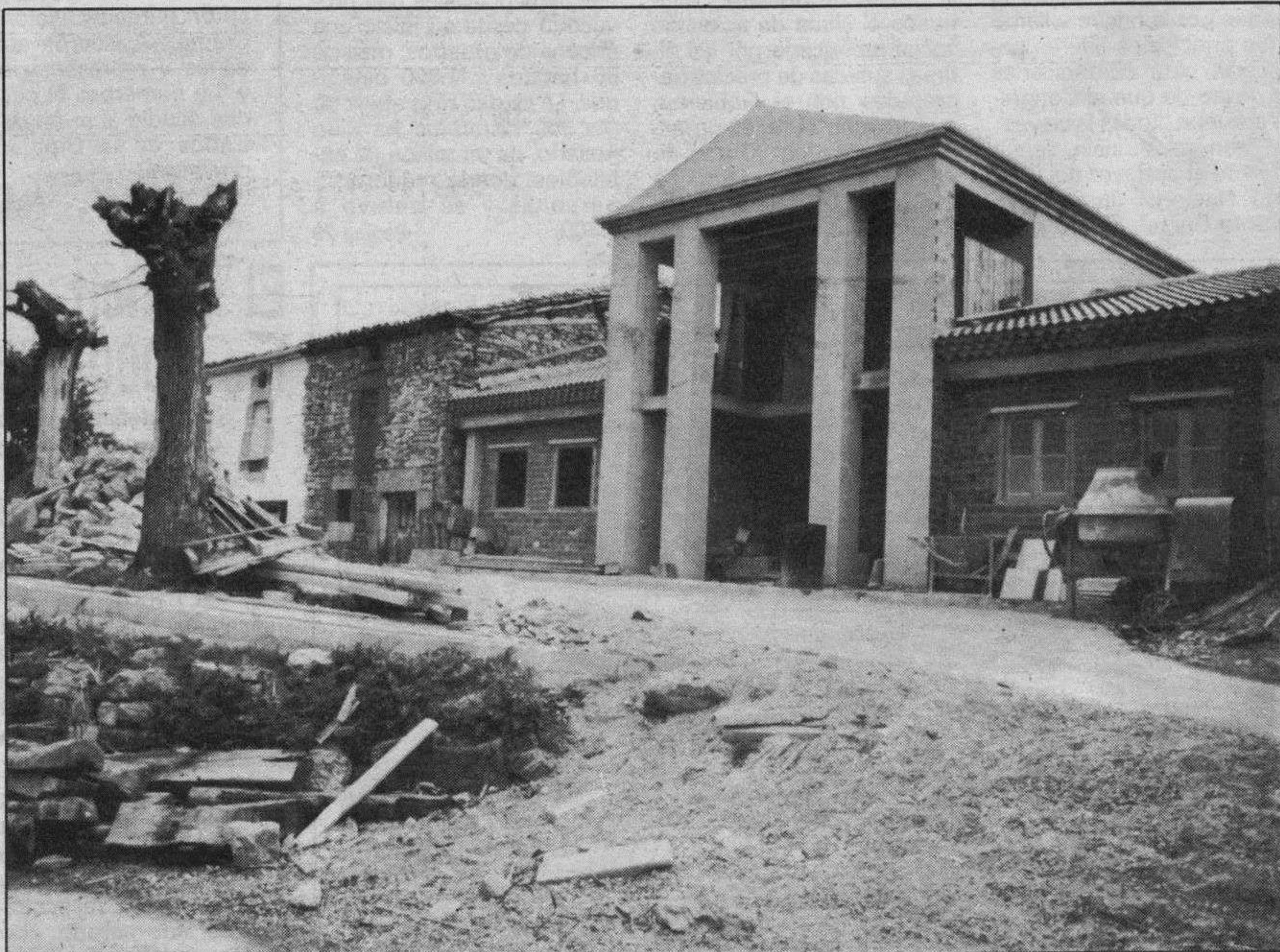
Nuevo edificio del Ayuntamiento de Vizcaínos. — Estas son las obras de construcción de la nueva Casa Consistorial de Vizcaínos, de corte clásico en su estructura es una realidad que reclama mayor celeridad en los trabajos para culminar cuanto antes el proyecto. Foto Pedro Antonio.
