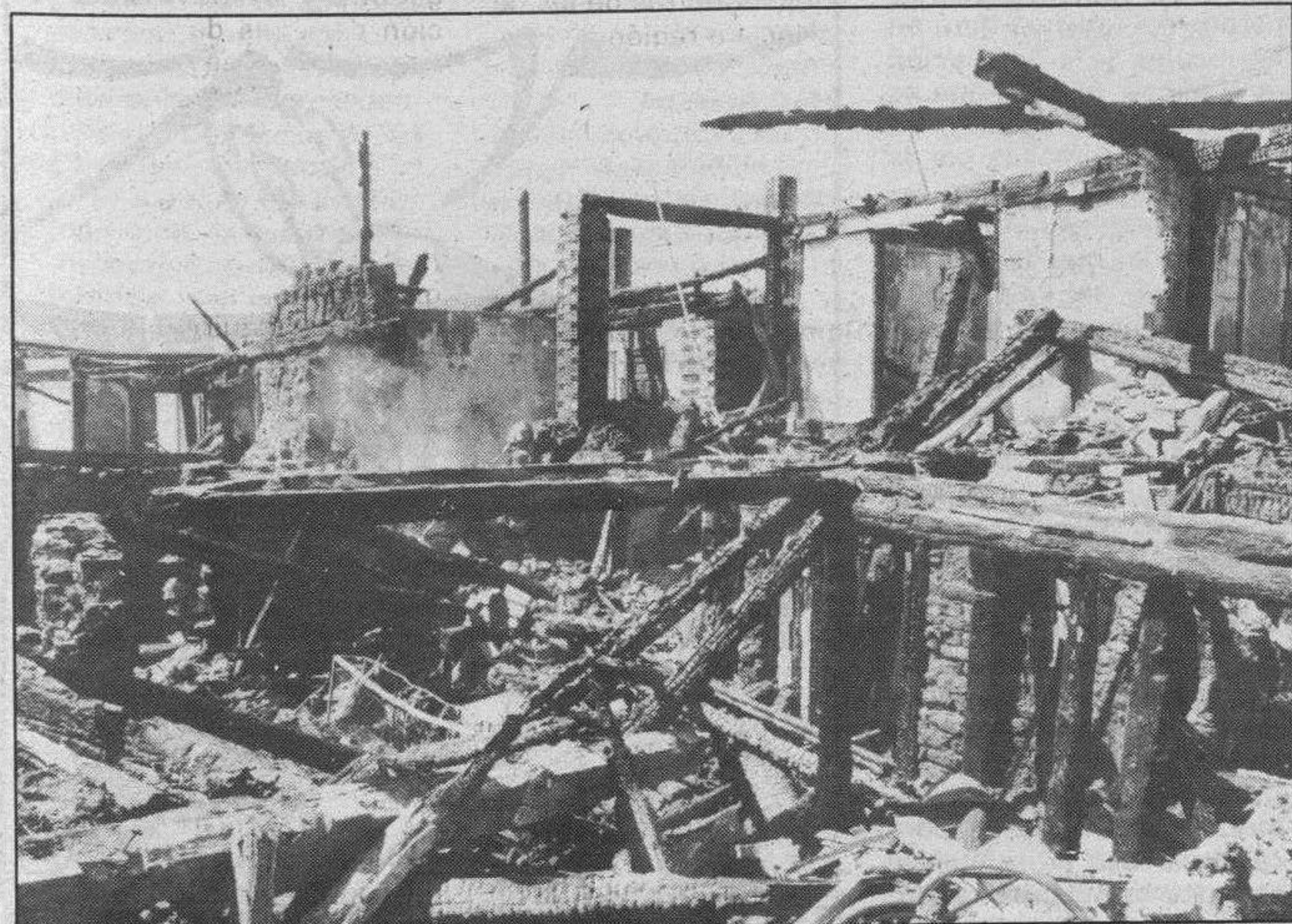
Tres días después del incendio, siguió saliendo humo de los escombros.
