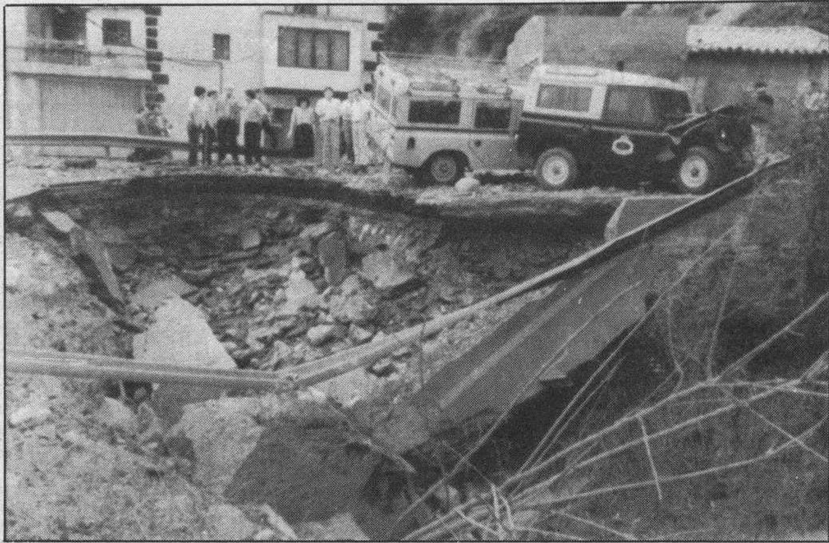
El artefacto explosivo colocado en el interior de una olla, bajo una alcantarilla, explotó poco después de que pasara un Land Rover de la Guardia Civil y otro de RENFE, que quedaron en el mismo borde del boquete causado por la deflagración.— Telefoto Efe.
