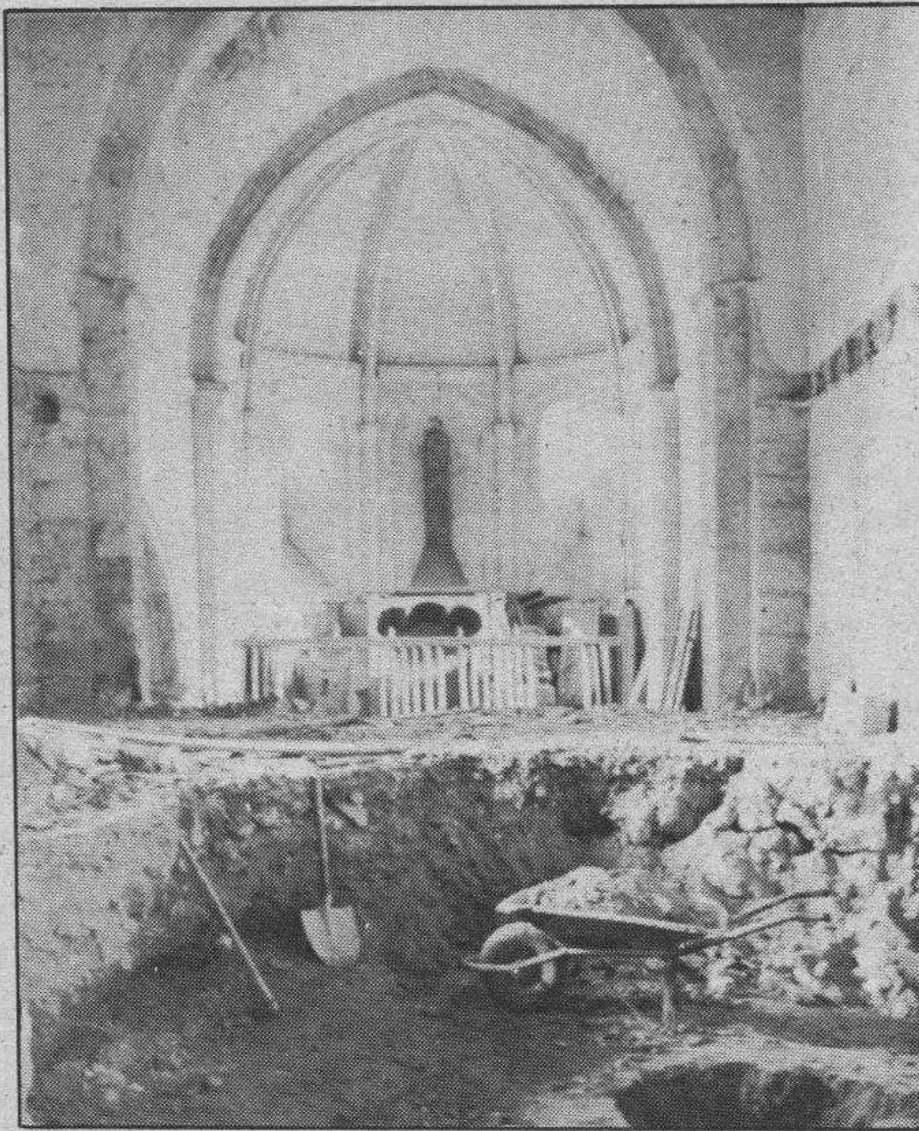
Nivel de escombros en la capilla-sacristía. Foto Lara.
