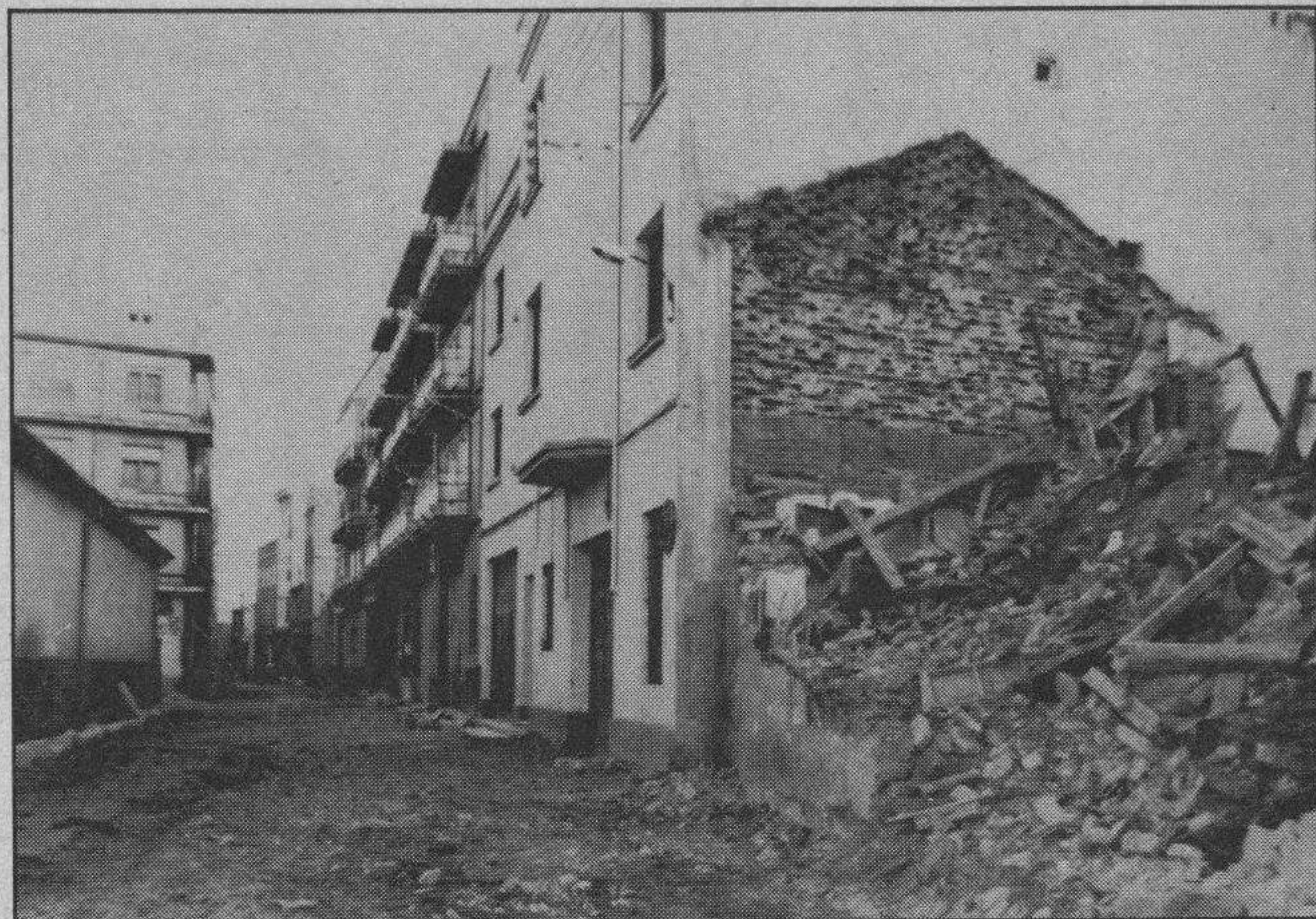
Comenzaron las obras en la calle Pío Baroja y con ello los problemas, este es el caso del derrumbamiento de esta casa con lo cual no hubo desgracias personales
