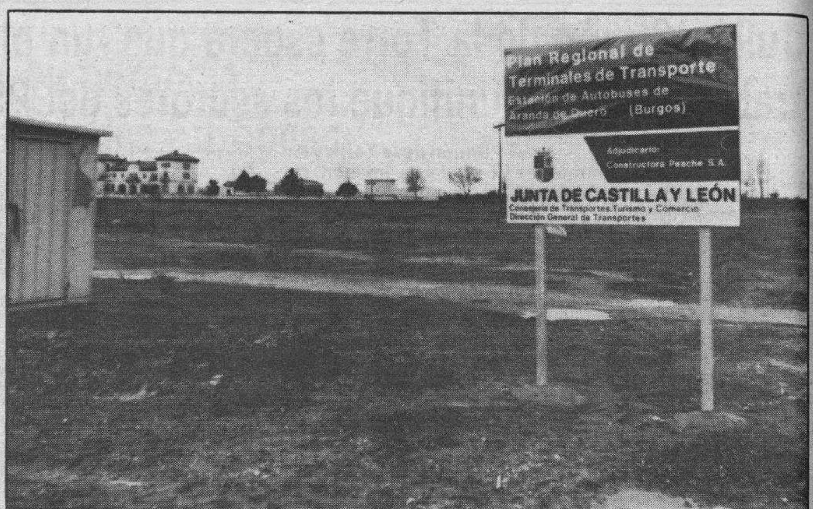
Con varios meses de retraso sobre las fechas previstas, están a punto de comenzar las obras de la estación de autobuses. El retraso hay que achacarlo a la existencia de un tendido de alta tensión no retirado tras la demolición de las casas que se levantaban en este lugar, lo que suponía un claro riesgo para los obreros de la nueva obra. El retraso afectará consecuentemente a su inauguración que no podrá ser ya en la próxima primavera. — Foto Lara.
