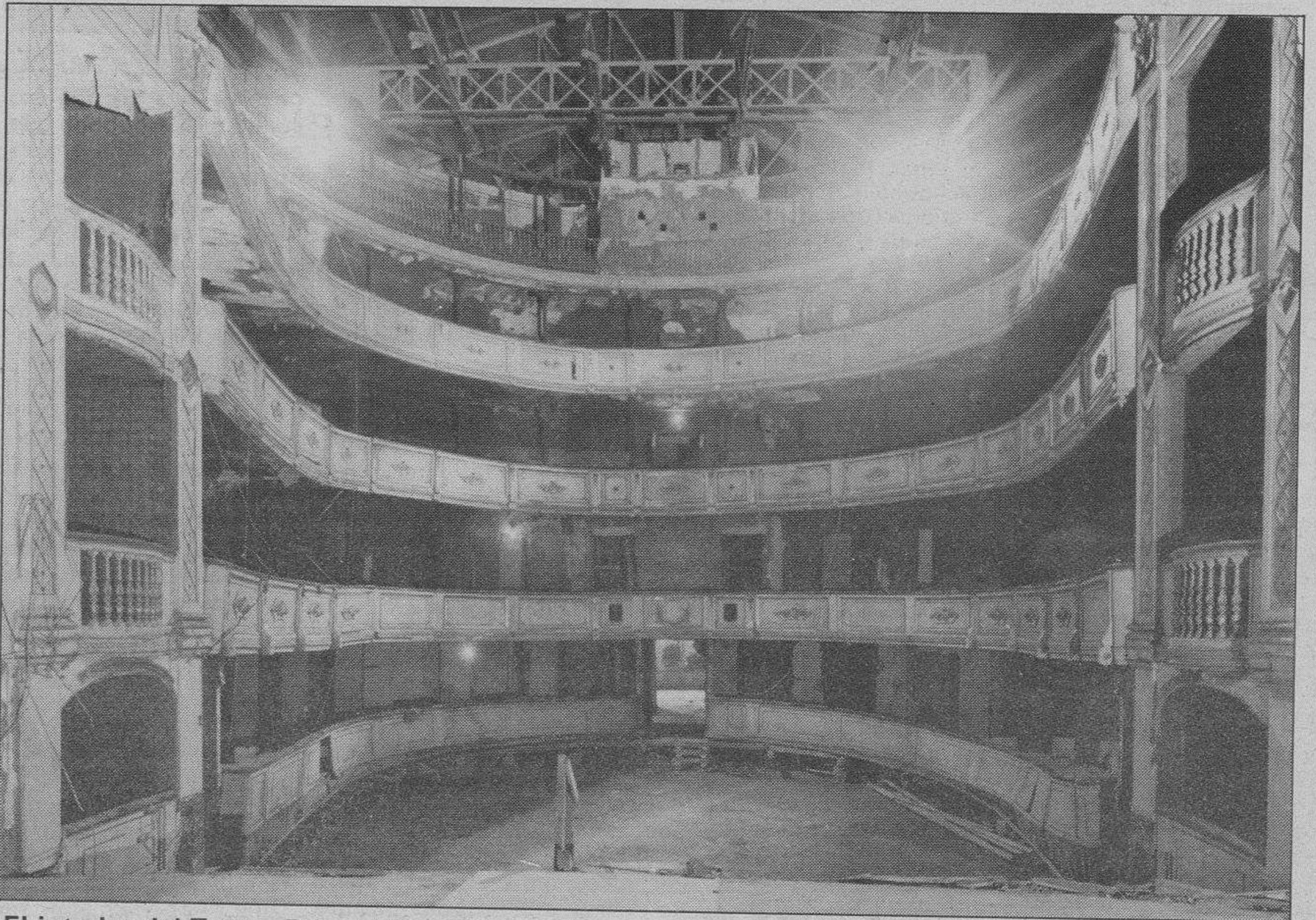
El interior del Teatro Principal. — Muchos son los comentarios que estos días giran en torno al polémico asunto del Teatro Principal. Muchos burgaleses sienten curiosidad por su estado que, acaso, conocieron antes. La fotografía nos muestra el interior de esas instalaciones cerradas hace ya varias décadas.
