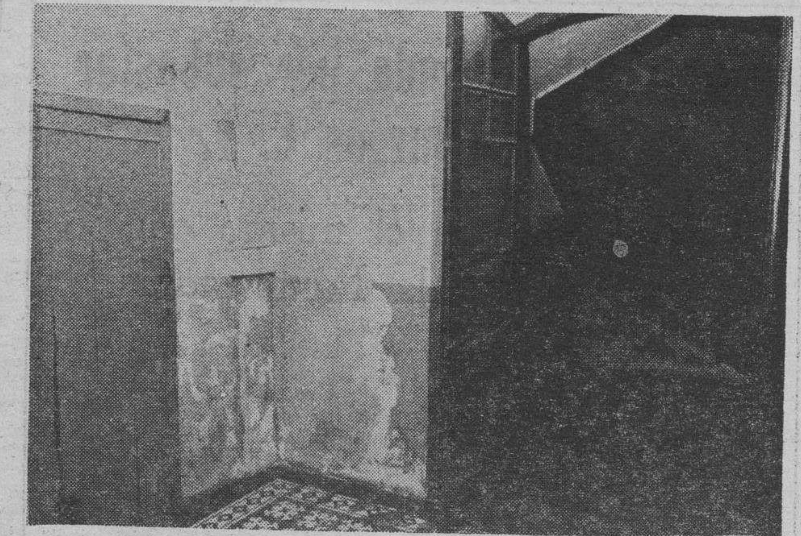
La entrada al edificio de Juzgados y Comisaría de Policía presenta este deplorable aspecto. Tampoco hay luz y faltan cristales. Las quejas parecen justificadas. (Foto Florentino Lara)
