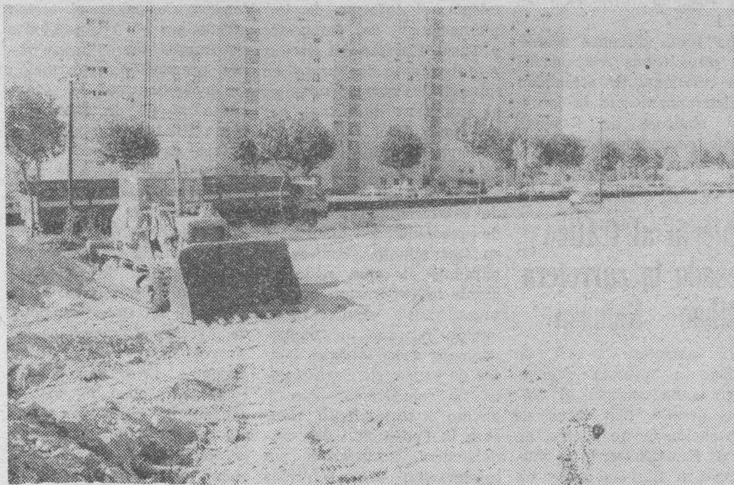
Los primeros trabajos para el comienzo de las obras de construcción del Parque de Bomberos y la sede de la Policía Municipal han empezado en terrenos próximos a la carretera de Santander. — (Foto FEDE)
