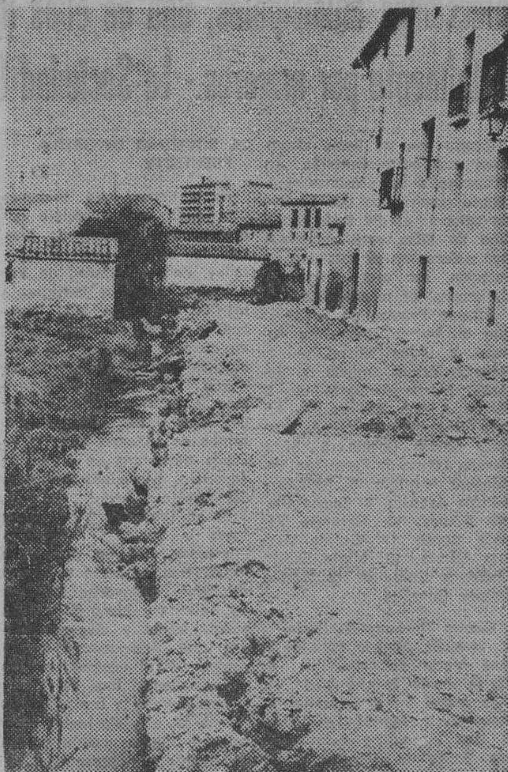
Siguen adelante las obras de urbanización de la calle Oroncillo. Ya están terminadas las correspondientes al saneamiento y las de conducción de aguas que procedentes del cauce de la Picota, transcurrian a cielo abierto por dicha calle. También se han colocado ya los bordillos de lo que serán aceras y solamente falta, para culminar la obra, hacer el firme de la calzada y asfaltar la misma.
