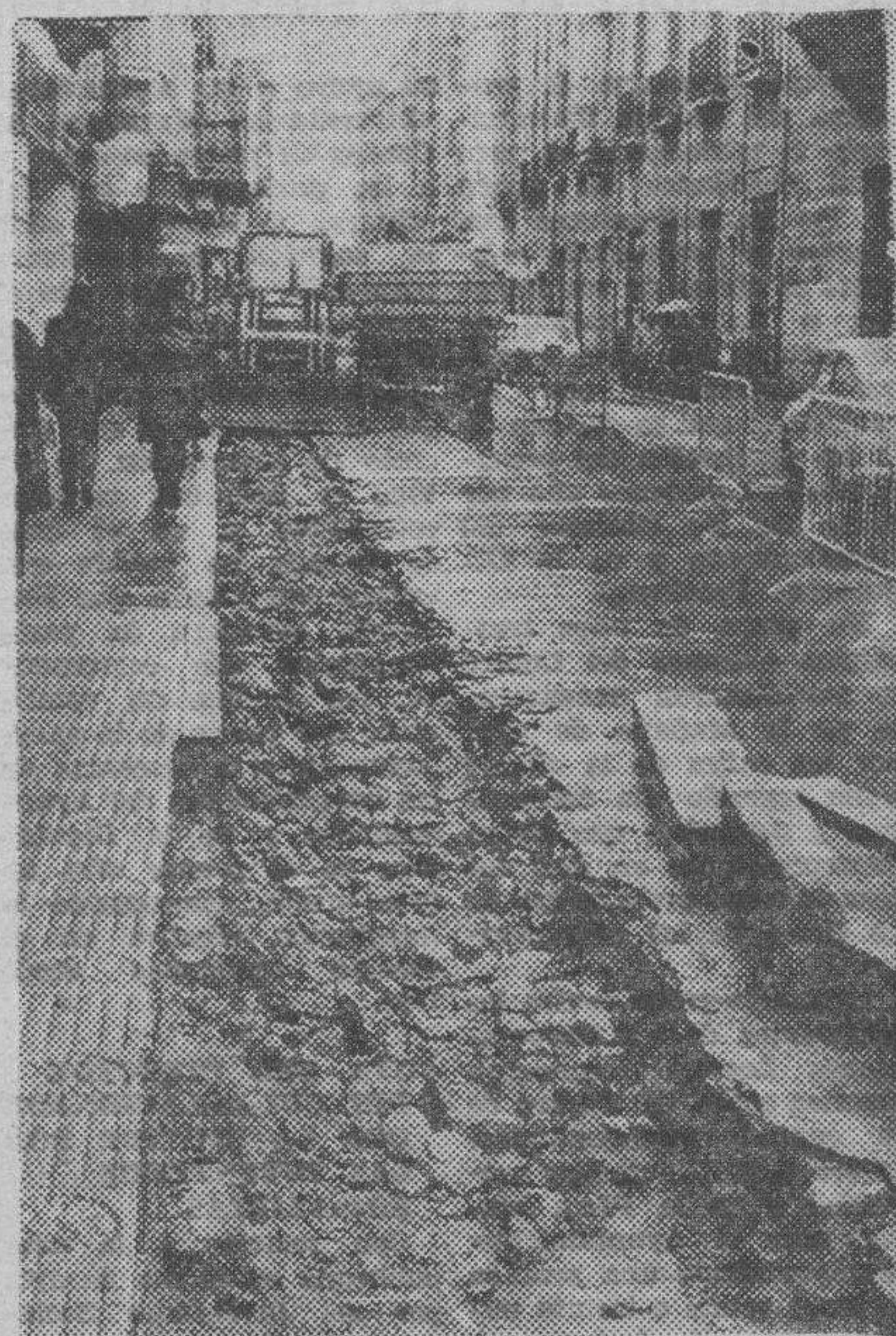
En la calle de Santander, la Brigada Municipal de Obras está realizando trabajos de ensanchamiento y mejora de las aceras, prohibiéndose con ello el aparcamiento de vehículos. — (Foto FEDE).
