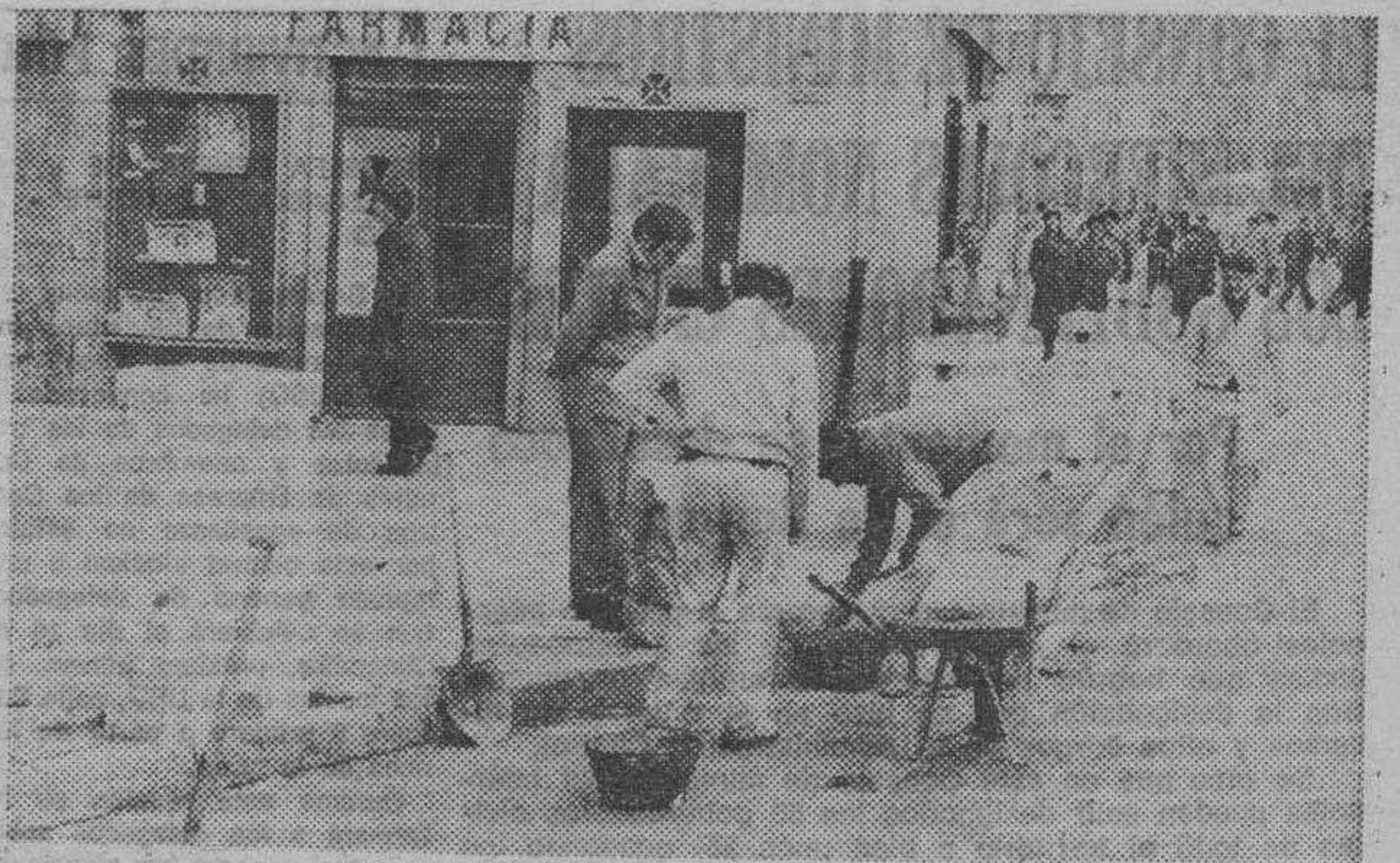
Estas son las obras de construcción de la nueva barandilla que se está haciendo en la Plaza de Santo Domingo de Guzmán. — (Foto FEDE).
