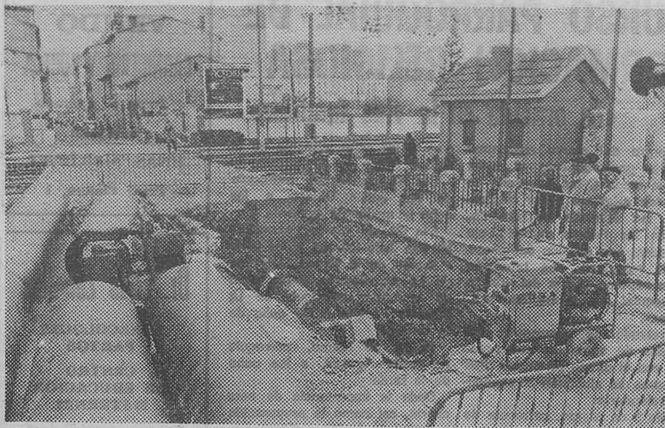
Estas son las obras de construcción de la red de alcantarillado de la calle de Santa Dorotea y San Pedro y San Felices. La máquina «topolino» trata de abrir un paso subterráneo, bajo la vía férrea. — (Foto FEDE).
