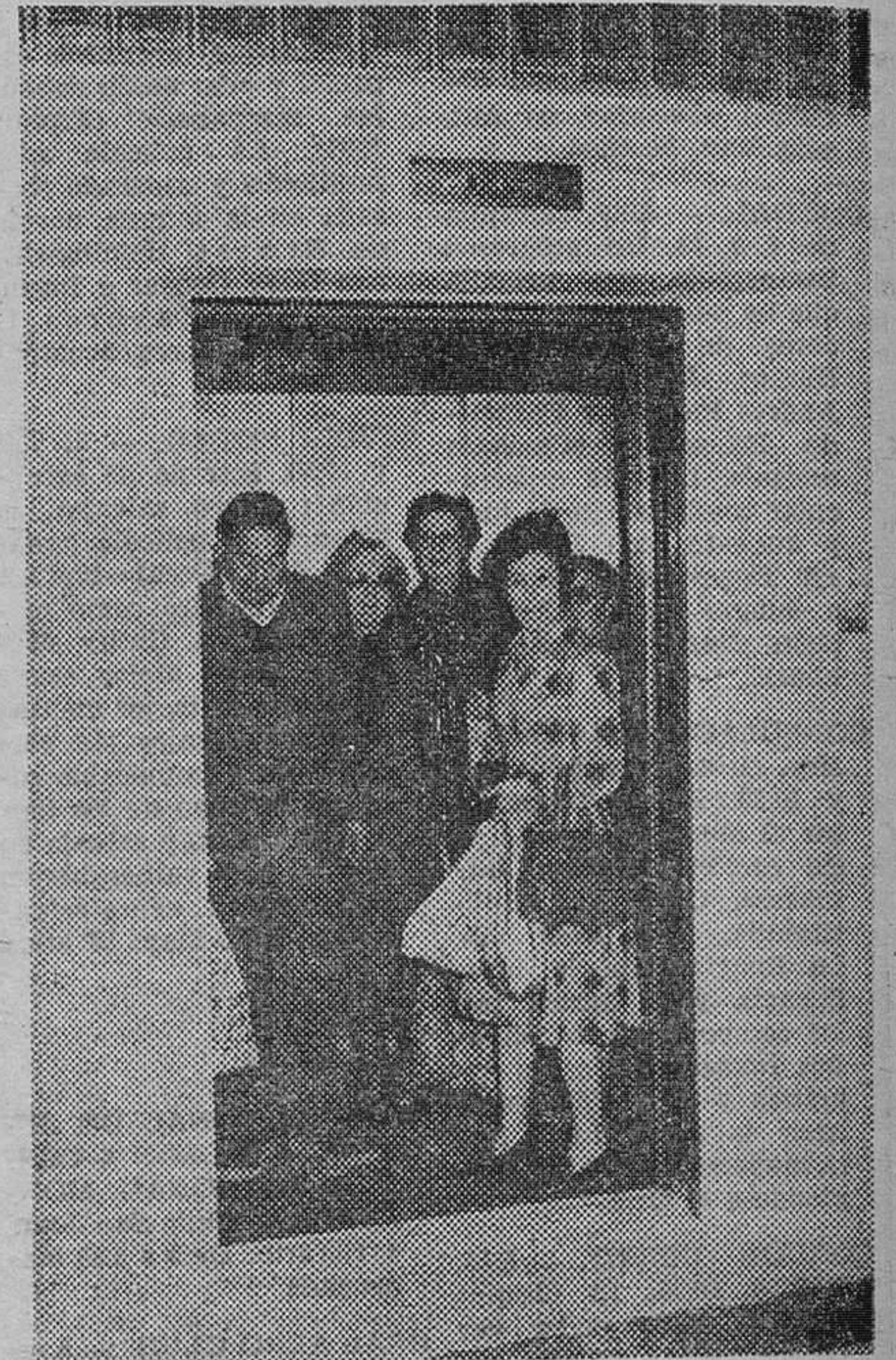
Se ha instalado un ascensor de servicio público en el Mercado de Abastos de la Zona Norte y ya ha empezado a funcionar. — (Foto FEDE)
